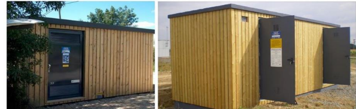
Exemples de poste de livraison électrique
